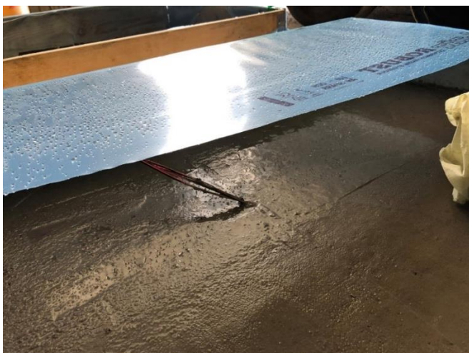
Figur 36. Kondensbildning under plasten.
